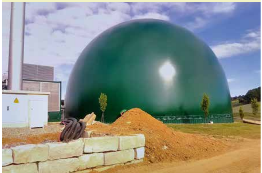
Der Aufbau von halb- und dreiviertel-kugelförmigen Doppelmembran-Speichern gleicht dem von Tragluftdächern auf Fermentern. Ein Stützluftgebläse sorgt dafür, dass die äußere Membran ständig gespannt ist.
