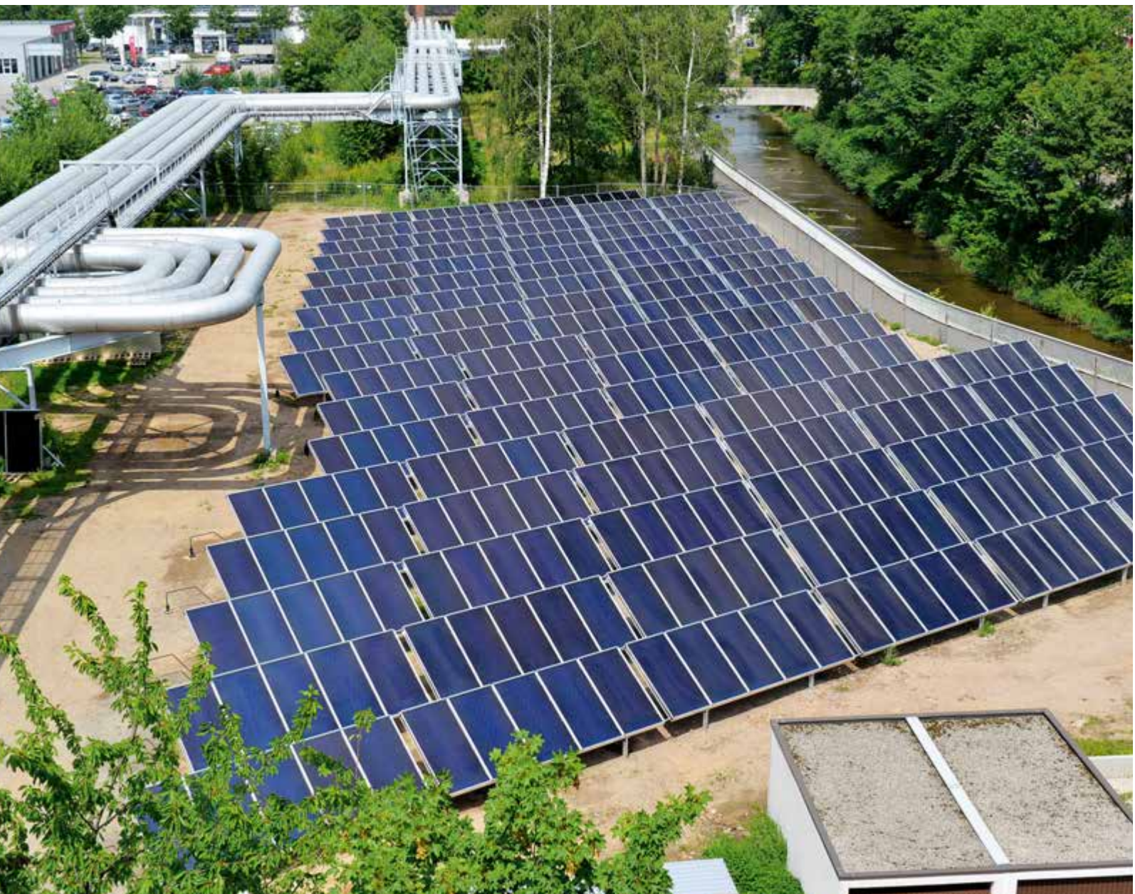
Wagner Solar hat für die Fernwärmeversorgung in Chemnitz im vergangenen Jahr ein Solarheizwerk installiert.
