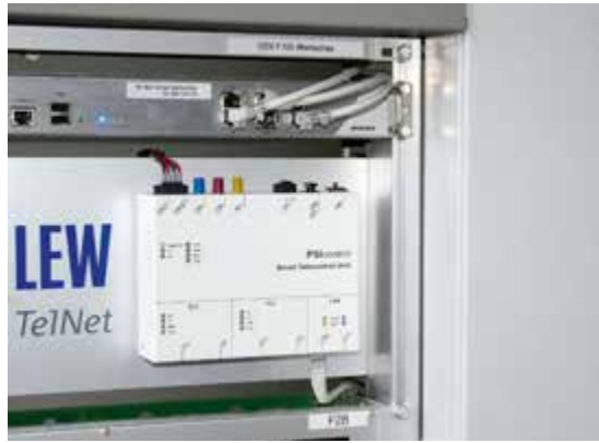
Das Herzstück der Smart-Grid-Installation: der Smart Operator
